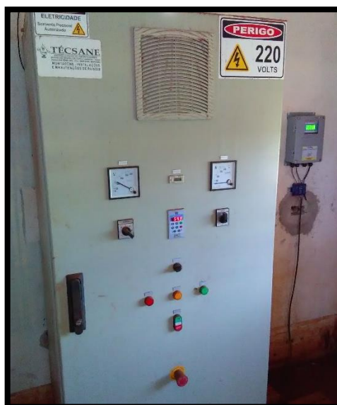
Imagem 02: Quadro de comando do poço 1
