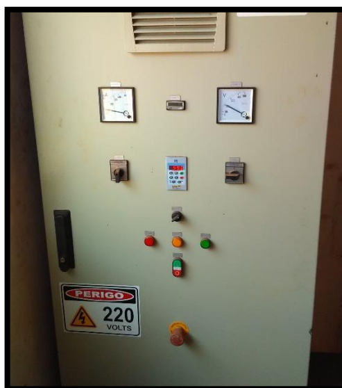
Imagem 06: Quadro de comando do poço da Rua José Reno de Andrade
