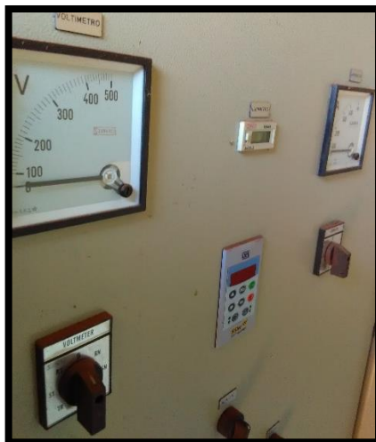
Imagem 04: Quadro de comando do poço 2
