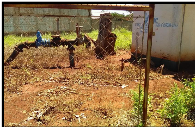
Imagem 01: Barrilete do poço 1
