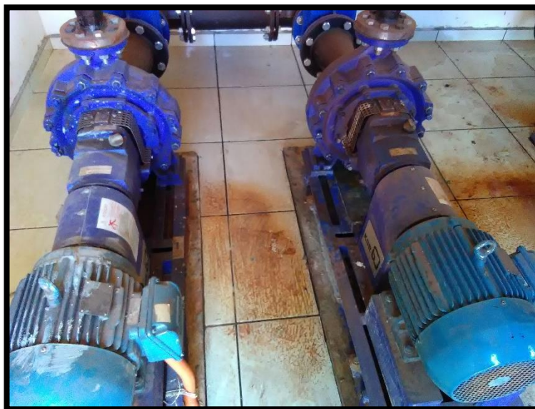
Imagem 14: Conjunto moto-bombas da elevatória 1
