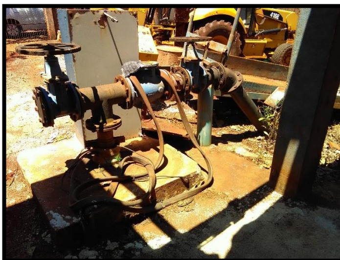
Imagem 05: Barrilete do poço da Rua José Reno de Andrade
