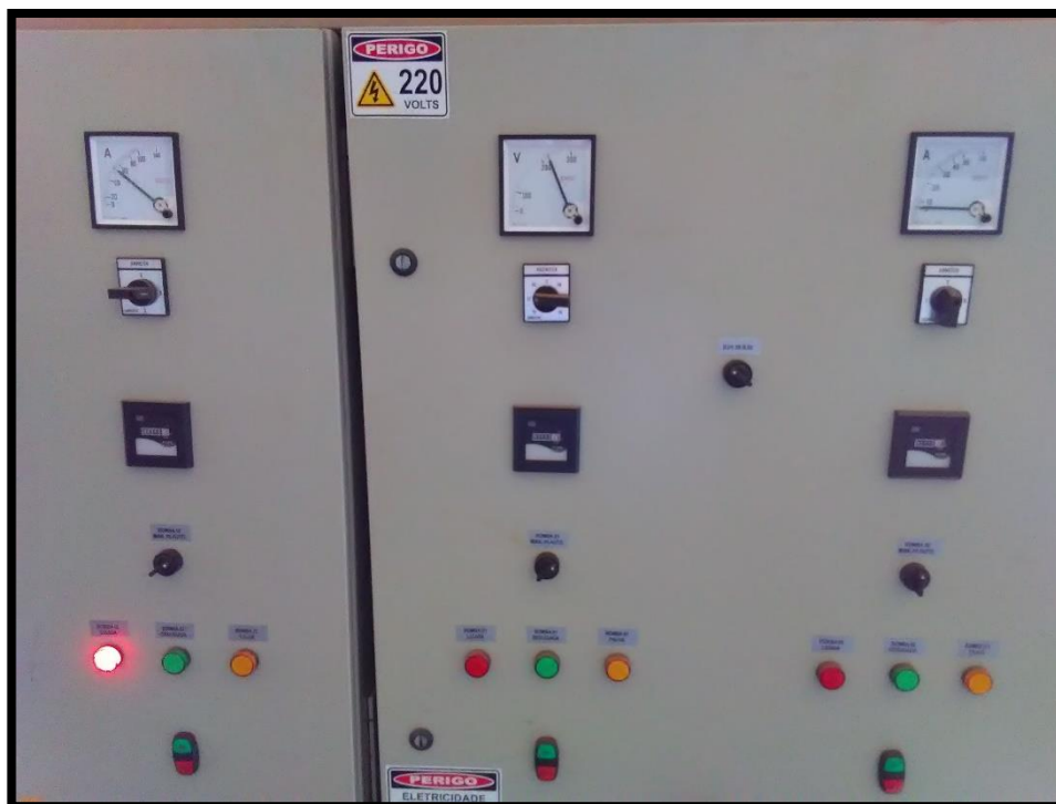
Imagem 16: Quadros de comandos das elevatórias
