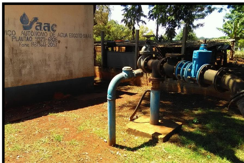
Imagem 03: Barrilete do poço 2
