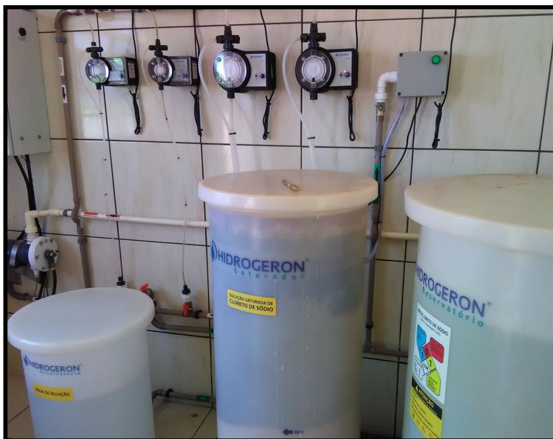
Imagem 09: Unidade de tratamento do reservatório
