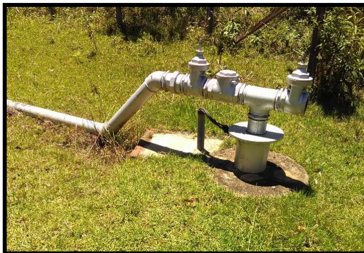
Imagem 05: Poço da fazenda Água do fuga
