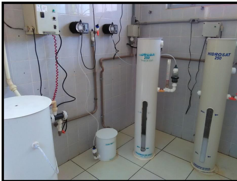
Imagem 07: Unidade de tratamento de água
