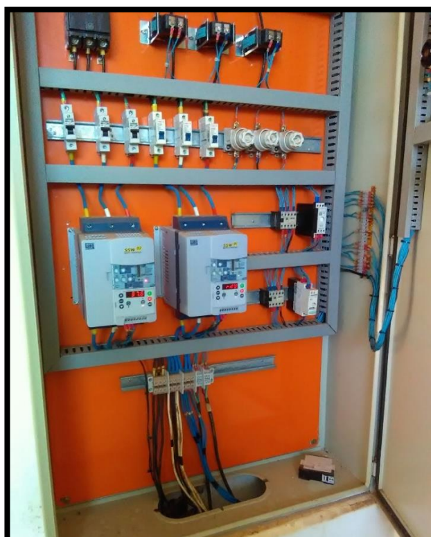
Imagem 13: Quadro de comando da estação elevatória de água
