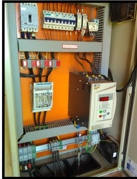
Imagem 02: Quadro de comando
