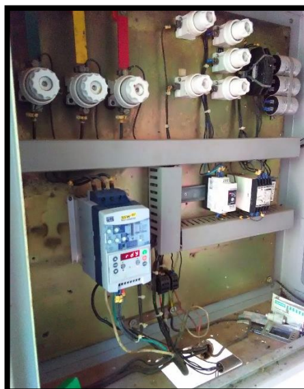
Imagem 04: Quadros de comando
