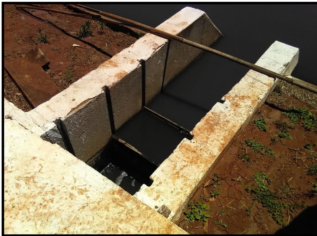
Imagem 22: Dispositivo de saída da lagoa facultativa
