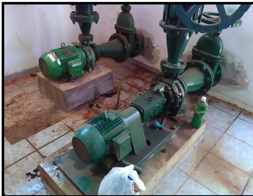
Imagem 12: Conjunto moto-bomba da elevatória
