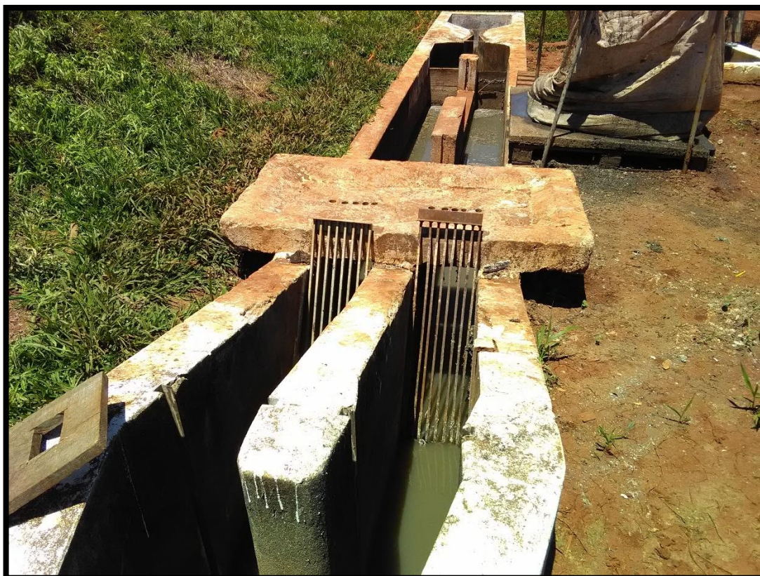
Imagem 19: Gradeamento, caixa de areia e medidor de vazão
